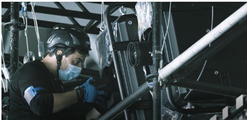
Installation des vidéoprojecteurs Panasonic lors des précédents jeux de Tokyo 2021.
